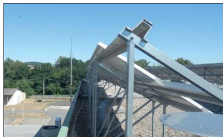
Obr. 2. Instalace aktivního jímáče ESE na střeše výrobní haly
