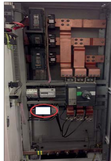
Obr. 4. Svodič přepětí SPD typu 1 + 2 (na bázi varistorů) umístěný v hlavním rozváděči
