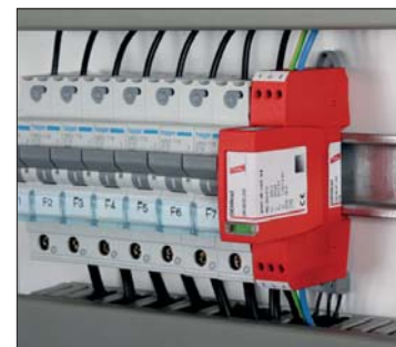
Obr. 6. DEHNrail M zapojený v rozváděči
