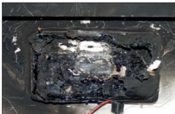
Obr. 2. Vyhořelá elektronika fotovoltaických panelů
