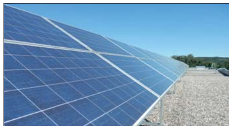
Obr. 1. Fotovoltaické panely bez jímací soustavy – instalace pouze podle NF C 17-102
