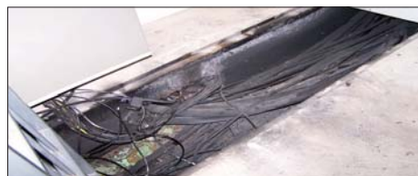
Obr. 3. Vnitřní kabeláž bioplynové stanice po požáru
