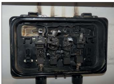
Obr. 3. Vyhořelá elektronika fotovoltaických panelů
