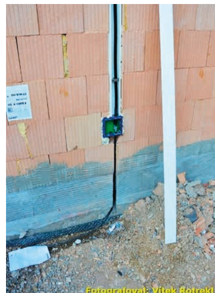
Obr. 20. Krabice uložena ve fasádě objektu – skryté svody
