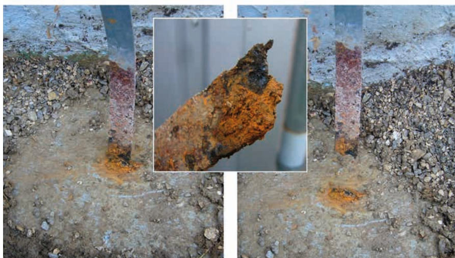
Obr. Korózia vývodu z uzemňovača pásovým vodičom FeZn na prechode betón – vzduch
