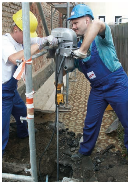
Obr. Inštalácia hĺbkového nadpáateľného uzemňovača
